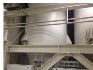
Foto 6. Wegende silo's voor de opslag van gereede product.
