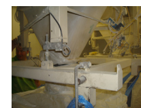
Foto 8. Een vulinstallatie voor big bags.
