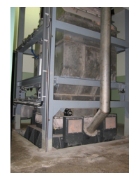
Foto 7. Een installatie voor het discontinu totaliserend verladen van bulkmateriaal.
