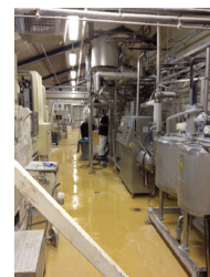
Foto 6. De opstelling van twee bufferketels met een kookinstallatie.
