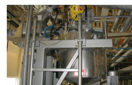
Foto 3. Een gecombineerde doseer- en menginstallatie.
